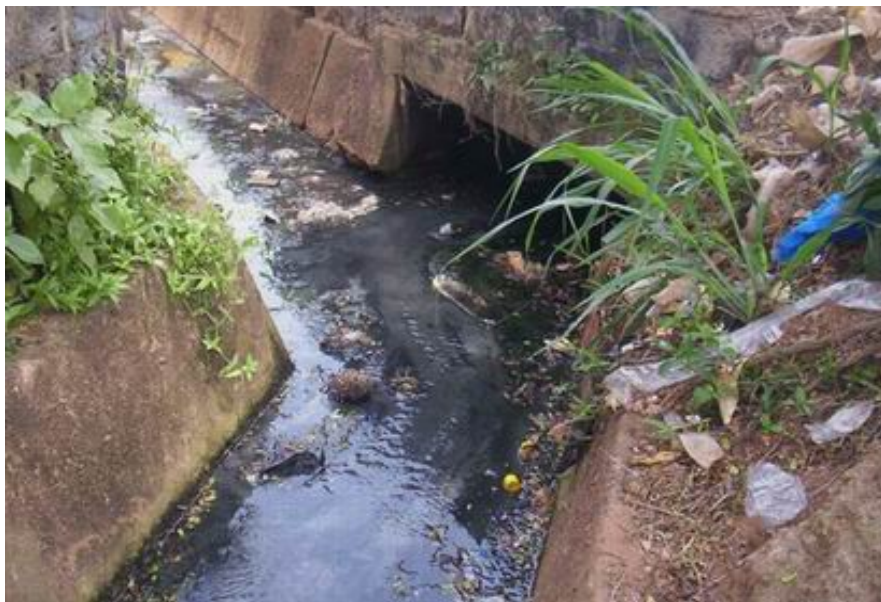
Canalisations à ciel ouvert pour les eaux de pluie.....
